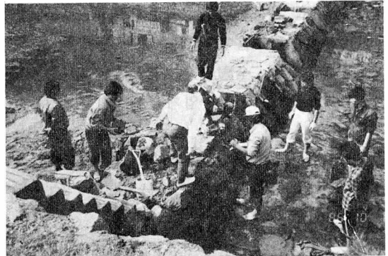
集團商街 河川 西萊橋 아래 沕補修
