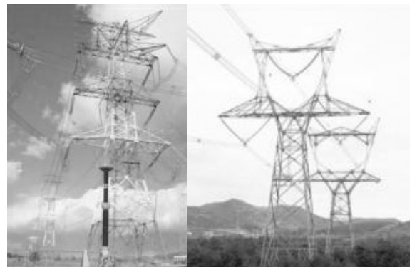
765kV 2회선 및 1회선 실증시험선로
