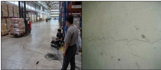
[그림 2] 물류센터 전경 및 균열 발생 현황
