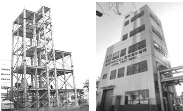
[그림 5] 보령화력본부 0.1MW CO 2 포집 설비
