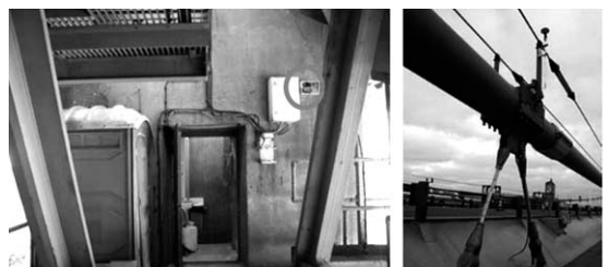
그림 8 신축이음부에 설치된 변위계(좌)와 중앙경간주케이블 위에 설치된 GPS 수신기(우)
