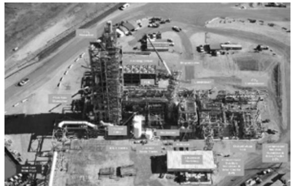
[그림 4] 미국 Plant Barry CO 2 capture plant
