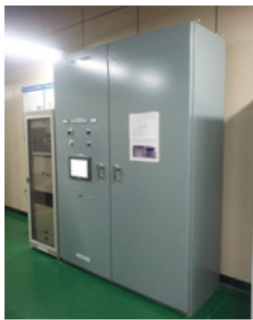
그림 2. 절연 저항 측정 장치 Fig. 2. Equipment for Measuring IR
